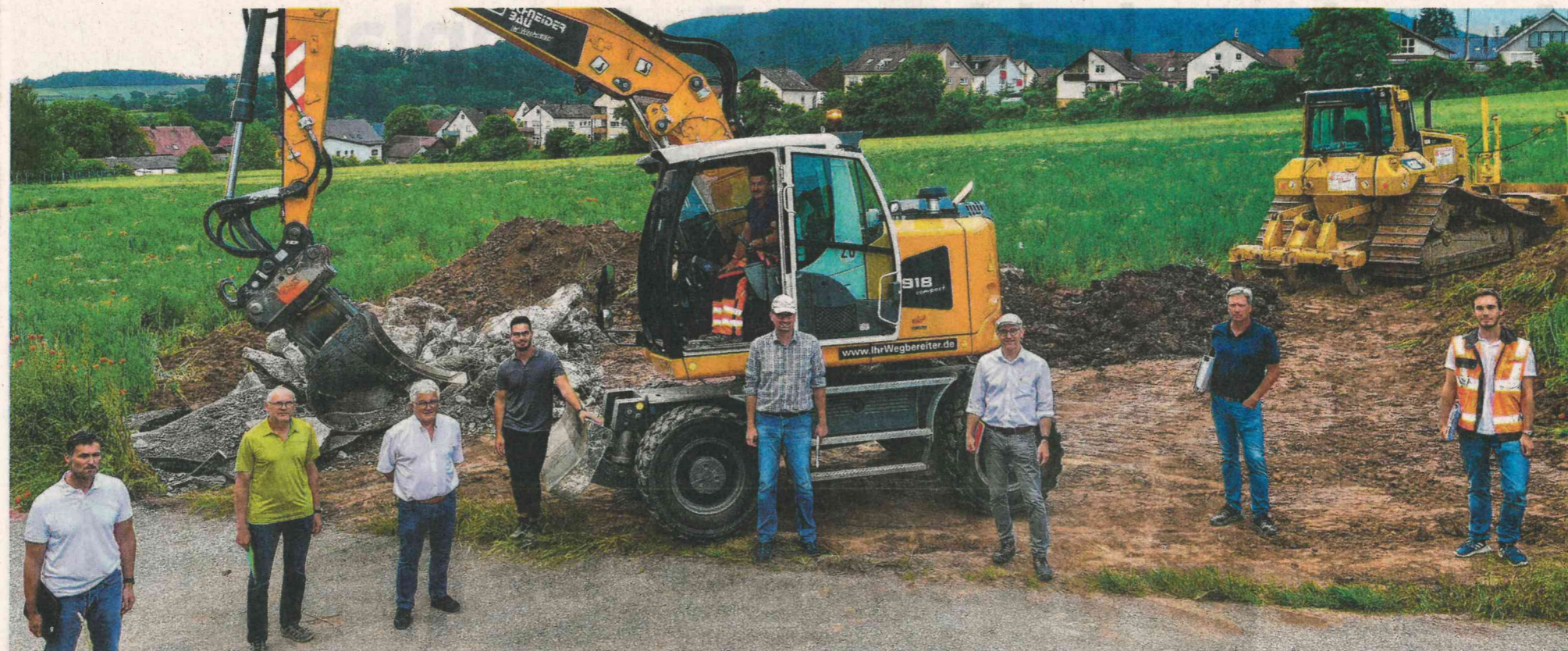
Bei der Baubesprechung zum Baggerbiss für das Baugebiet Leimengrube holten sich die Beteiligten um Sachsenheims Tiefbauamtsleiter Pablo Burkhardt (3. von rechts) die aktuellen Zeitpläne. Foto: Martin Kalb
