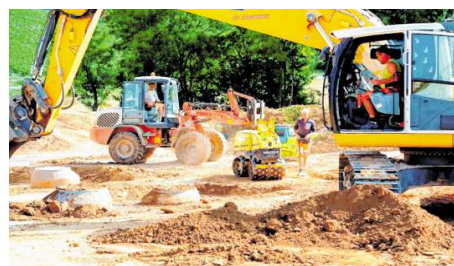
Die Firma Konrad Bau arbeitet auch viel im Bereich Ver- und Entsorgungsleitungen.
